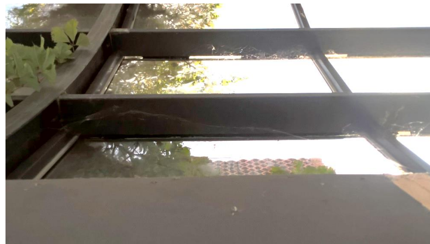
Joints de menuiseries manquants
