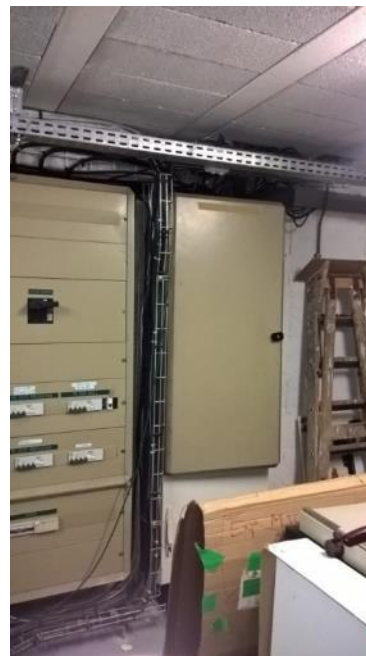
Local maintenance à R+1
